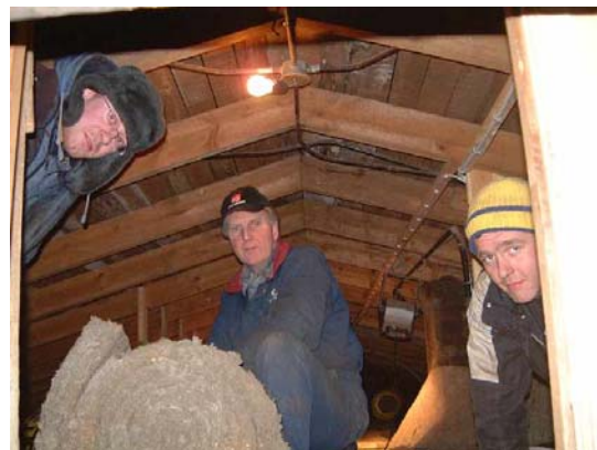
Ásmundur, Theódór og Eyvindur leggja einangrun á loftið á starfsmannahúsinu á Tumastöðum.
