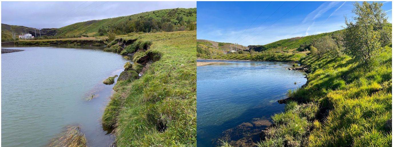
Bakki Andakílsár fyrir og eftir framkvæmdir. Á vinstri myndinni má sjá að gróðurtorfur hafa rofnað frá bakkanum og fallið í ána. Á þeirri hægri sjást sjálfbærar bakkavarnir í Andakílsá haustið eftir að framkvæmdum lauk. Gróðurtorfurnar eru farnar að spretta vel og öll birkitré og víðirunnar lifandi og gróskumiklir. Ljósmyndir: Orka náttúrunnar.
